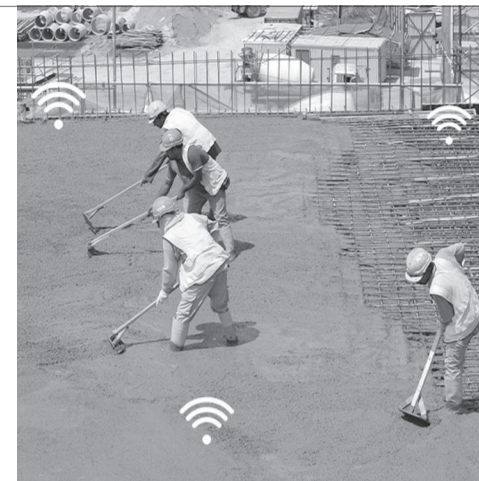
В 2020 году канадская компания AOMS Technologies разработала датчики и ПО, которые позволяют в реальном времени наблюдать за состоянием бетона: его влажностью и температурой на разных участках. Собранный с сенсоров информация обрабатывается программой, которая строит график набора прочности и оценивает зрелость конструкции. Вся информация передается в реальном времени по вай-фай. Источник: AOMS Technologies
